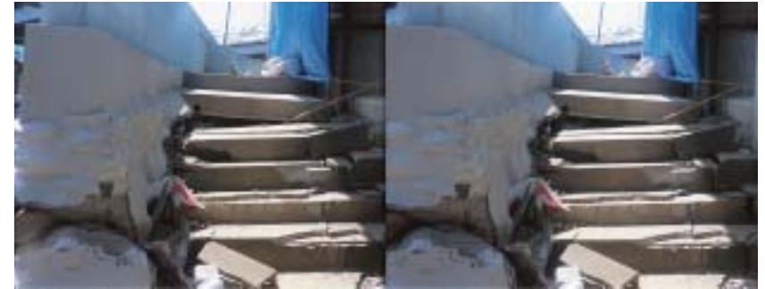
(e) 崩れた階段 (玄界島)
