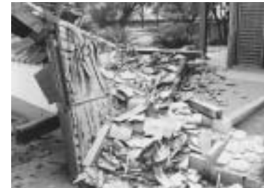
(a) 崩落した屋根
