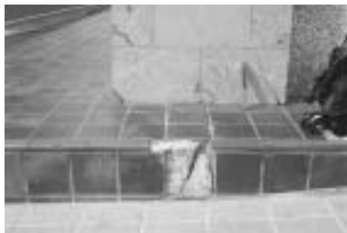
図 31 博多駅前の建物被害 (2005年4月6日撮影)
