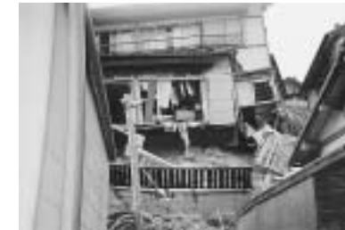
図8 建物基礎が崩落した損壊住宅（2005年4月2日撮影）
