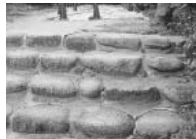
(b) 亀裂が生じた石段 (2005 年 4 月 23 日撮影)
