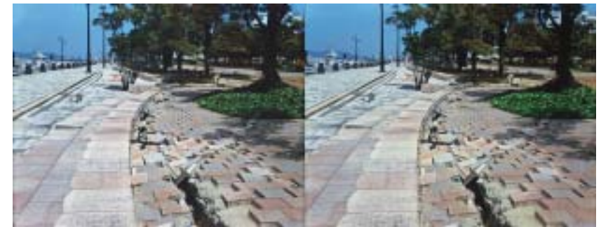
(f) 博多港南岸の舗装の陥没・隆起
