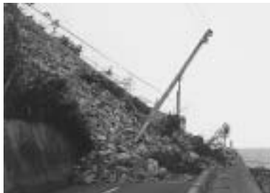
(a) 県道を寸断した崩壊土砂 (2005 年 4 月 23 日撮影)
