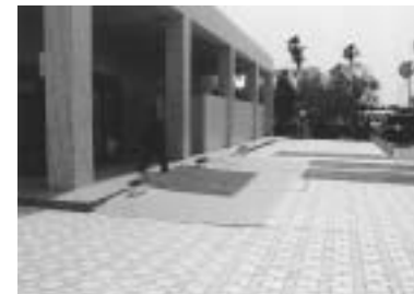
(a) ホテル海の中道の基礎部分の亀裂 (2005年5月15日撮影)
