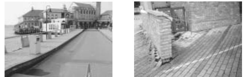
(a) 沈下した歩道（正面は「マリゾン」） (b) 図書館前の舗装面の変形
