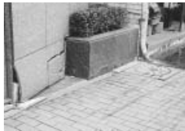
(b) ビル基礎部分に生じた亀裂
